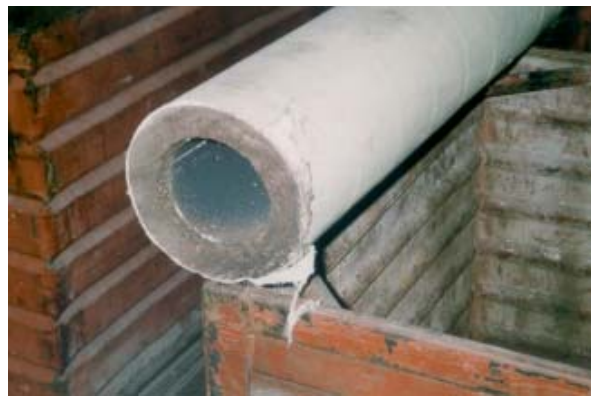
Asbesthaltige Rohrisolation, Foto: MS, IST
