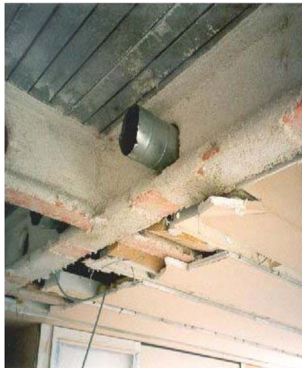
Spritzasbest an einer metallischen Tragkonstruktion, Foto: JMF/SLE, IST
