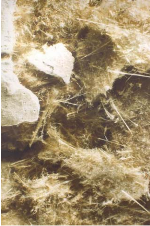
Vergrößerung eines Spritzasbestbelags. Zu sehen sind Fasern aus Mineralwolle und lange, spitze Asbestfaserbündel, Foto: SA
