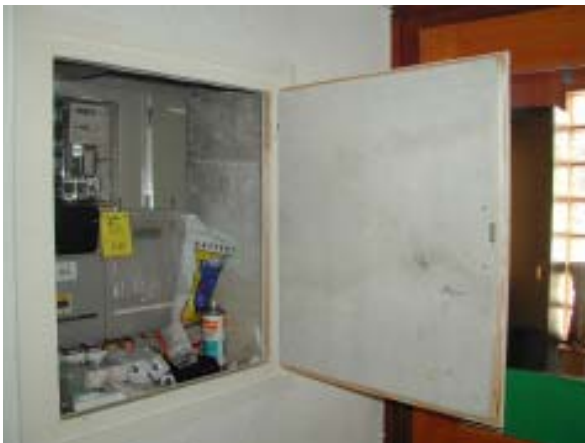
Sicherungskasten mit asbesthaltiger Brandschutzplatte an der Innentür, Foto: JMF/SLE, IST
