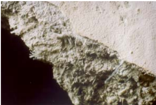
Zerbrochene Asbestzementplatte mit sichtbaren Asbestbüscheln, Foto: SA
